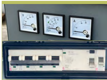
INSTRUMENTS AND BREAKERS STRUMENTI E INTERRUTTORI
